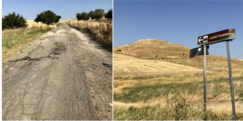
Le pessime condizioni della strada provinciale e della segnaletica che conducono a Castel Fiorentino
